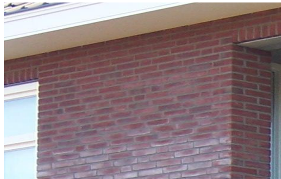
Bestanddelen die vergipsing veroorzaken verplaatsen via de poriën in de mortel en de steen naar het oppervlak. Water verdampst en gips wordt als uitslag zichtbaar aan het oppervlak.
